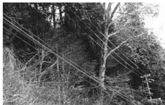
電線等の支障となっている枝条
