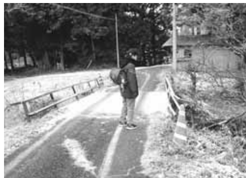
欄干が低く変形した伊奈川水沢4号橋
