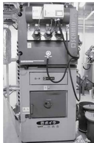
視察した設楽町庁舎の チップボイラー
