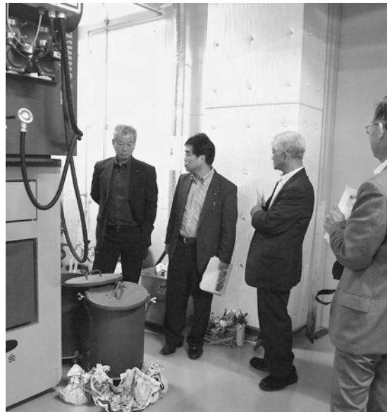
木質チップボイラーを見学（愛知県設楽町役場）
