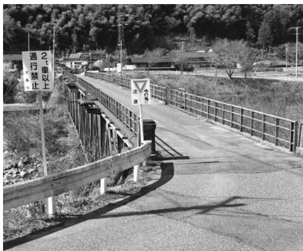
通行制限の大桑橋
